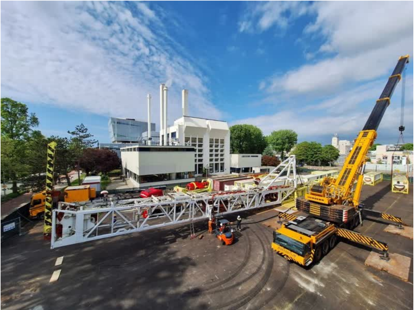
Ter illustratie: Geothermie Delft
